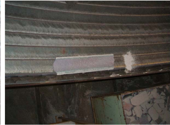
フラックス・溶接スラグ
